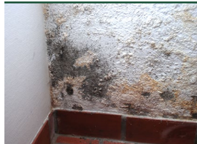
Skimmelangreb i kælderrum
