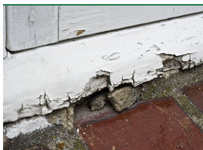
Gråmuld (Overfladeråd) - drypnæse på gammelt vindue.
