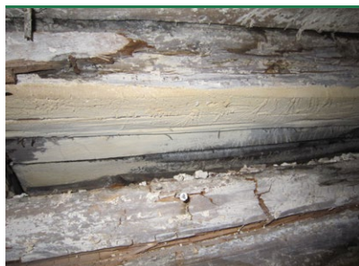
Hvid Tømmer-svamp - frugtleger, overflademycelium og sprækkeklodser i etagebjælke. (Foto: Bøgh & Helstrup)
