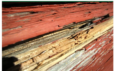
Korkhat - bladet nedbrydning i bjælkehus. (Foto: PROTOX)
