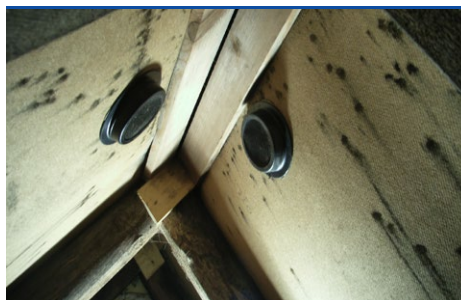
Sortskimmel på undertag pga. manglende ventilation af tagrum (ventiler eftermonteret). (Foto: PROTOX)
