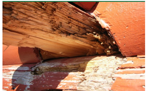
Korkhat - nedbrydning i bjælkehus. (Foto: PROTOX)
