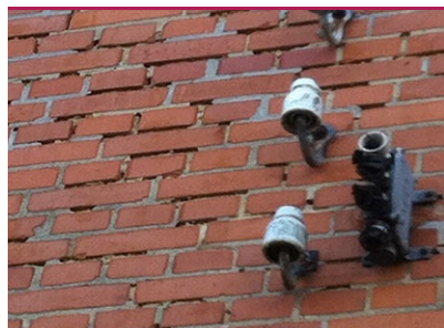
Murbi - ødelagte fuger i muret gavl. (Foto: PROTOX)
