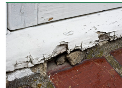
Gråmuld (Overfladeråd) - drypnæse på gammelt vindue.
