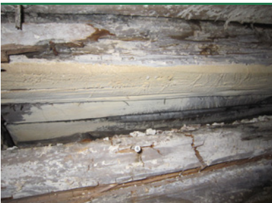
Hvid Tømmersvamp - frugtlegereme, overflademycelium og sprækkeklodser i etagebjælke. (Foto: Bøgh & Helstrup)
