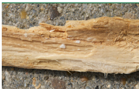
svn 39 Korkhat i udvendig beklædning. Bemærk små totter af overflademycelium på brudflader (Foto: Protox)
