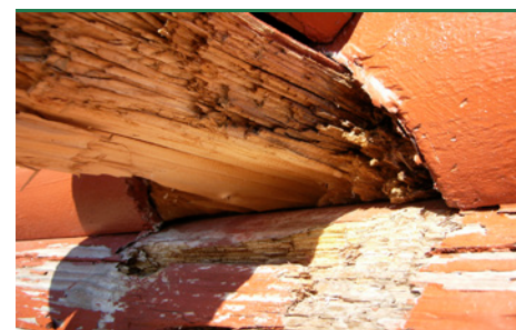
Korkhat - nedbrydning i bjælkehus. (Foto: Protox)
