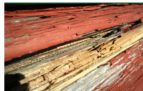
Korkhat - bladet nedbrydning i bjælkehus. (Foto: Protox)
