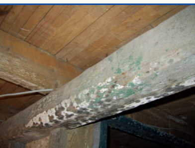
sk 1 Skimmelangreb - Trichoderma sp. i kælderbjælke efter rørska- (Foto: Protox)
