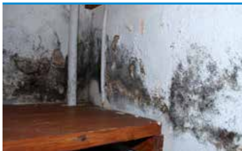
skn 6 Svartmögel på fuktbelastad källargrund (foto - Protox)
