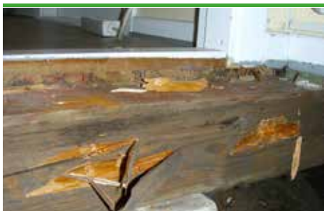
svn 41 Kjellersopp - bjelke med intakt overflate. Nedbrutt fra innsiden (foto - Goritas)
