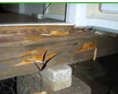
sv 9 Kjellersopp - bjelke nedbrutt med intakt overflate (foto - Goritas A/S)
