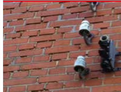
Sommersilkebie - ødelagte fuger i murt gavl (foto - Prottox)
