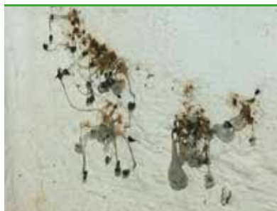
Husblekksopp - inntørkede fruktlegemer på pusset vegg (foto - Goritas)
