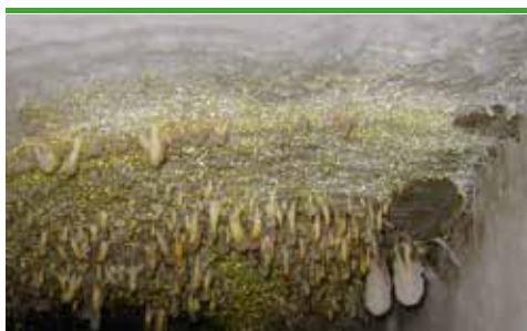
svn 28 Ekte hussopp - overflatemycel med vanndråper (foto - Bøgh & Helstrup)
