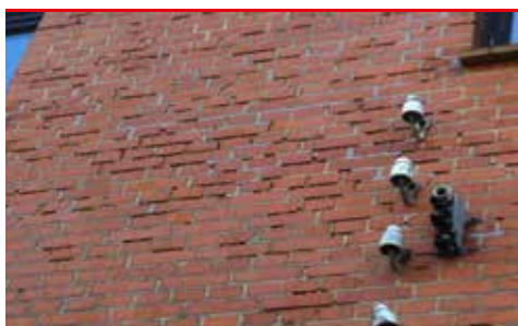
inn 23 Sommersilkebie - fuger i mur delvis brutt ned (foto - Protox)
