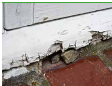
Gråråte (overflateråte) - dryppnese på gammelt vindu
