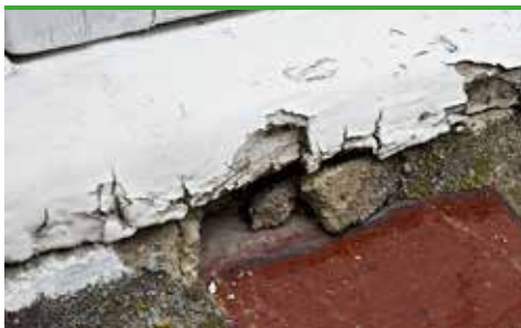
svn 58 Overflateråte (gråråte) - dryppnese på gammelt vindu (foto - Protox)
