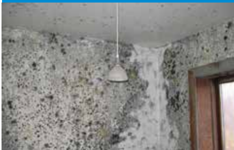
skn 7 Muggvekst i oppholdsstue etter vannskade (foto - Protox/kundefoto)
