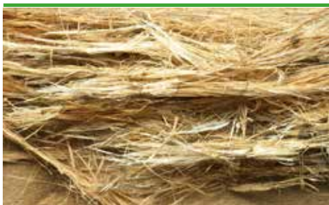
svn 52 Hvitråte nedbryting - ukjent sopp (foto - Protox)
