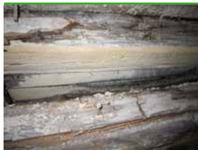
Kjellerkjuke - fructlegemer, overflatemycel og sprekkeklosser i etasjebjelke (foto - Bøgh & Helstrup))
