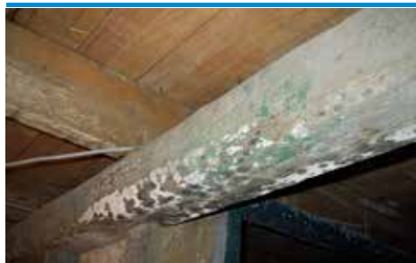
skn 1 Muggvekst (Trichoderma sp.) på vannskadet bjelke i kjeller (foto - Protox)
