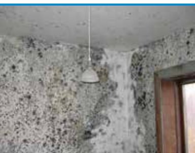
sk 3 Muggvekst i et familiehus etter omfattende vannskade (foto - Protox/kundefoto)
