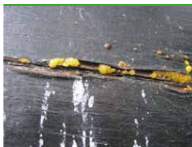
Tåresopp - fruktlegemer på utvendig treverk (foto - Goritas A/S)
