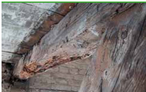
svn 56 Vanlig råte i frilagt takbjelke. (foto - Protox)
