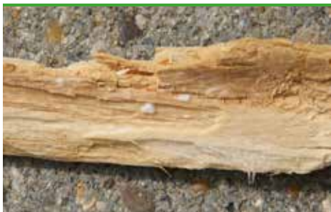
svn 39 badstumusling i utvendig bekledding. Legg merke til små totter av overflatemycel på bruddflater (foto - Protox)
