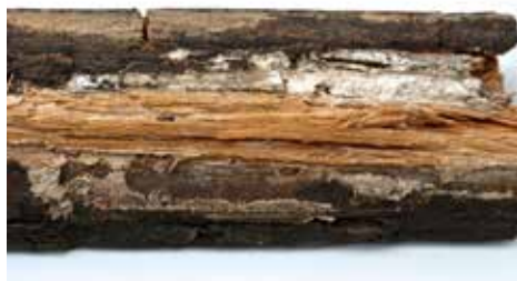
svn 53 Barksopp i vindusramme (hvitråte/råte) (foto - Goritas)
