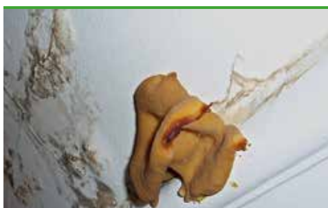
svn 18 Beggersopp - fruktlegerme på vegg ved gulvlist (foto - Bøgh & Helstrup)
