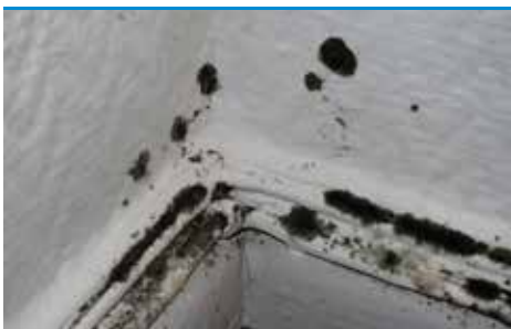
skn 11 Svertesopp på gulvlist - mangelfull utlufning (foto - Protox)
