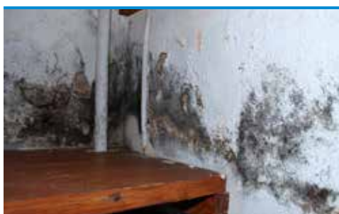
skn 6 Sortmugg på fuktbelastet kjellerfundament (foto - Protox)
