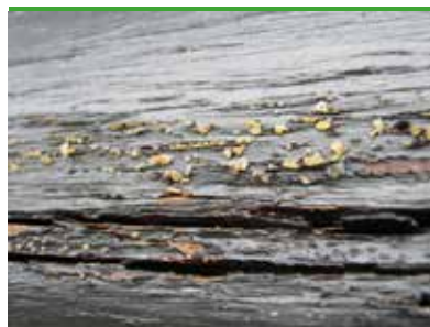
Tåresopp på utvendig treverk (foto - Goritas A/S)
