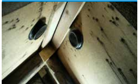
skn 8 Svertesopp på undertak pga. manglende ventilasjon av loft (ventiler ettermontert) (foto - Protox)
