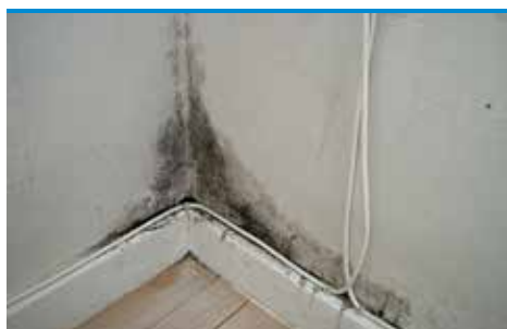
skn 5 Sortmugg i oppholdsstue - oppstått ved kuldebro (foto - Protox)
