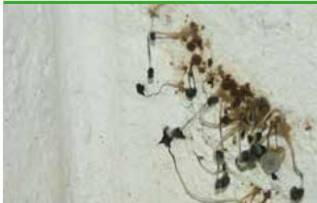
svn 19 Husblekksopp - fruktlegemer på pusset vegg (foto - Goritas)
