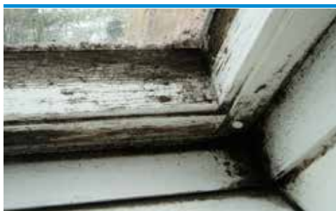
skn 4 Sortmugg på takvindu - mangelfull utlufting (foto - Protox)
