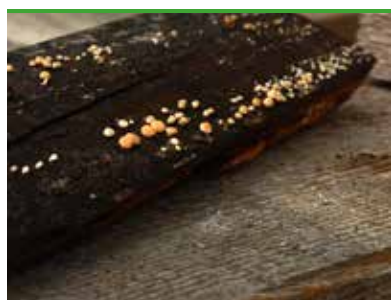
Rottåre - fruktlegemer på utvendig treverk (foto - Protox)
