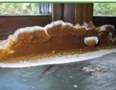
sv 1 Ekte hussopp - fruktlegeme i vinduskarm/lysning - legg merke til innskruvinger i vinduets ramme/post
