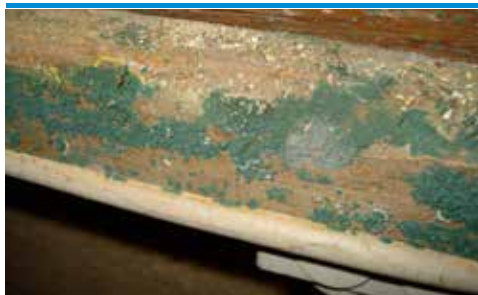
skn 2 Muggvekst (Trichoderma sp.) på forskalingsbord i vannskadet krypkjeller (foto - Protox)
