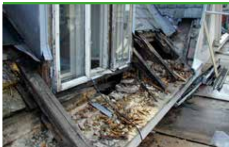
svn 55 Vanlig råte - takskjegg nedbrutt (foto - Tryg Forsikring)
