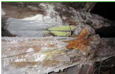
svn 33 Hvit tømmerkjuke - angrep i takkonstruksjon. Kalkaktige fruktlegemer, ung, hvitt mycel og bøyelige strenger (foto - Bøgh & Helstrup)
