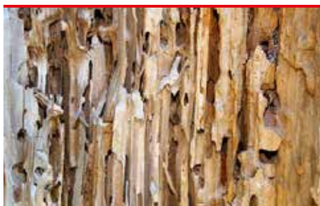
inn 22 Stokkmaur - nedbryting (gallerier) av tre (foto - ukjent)
