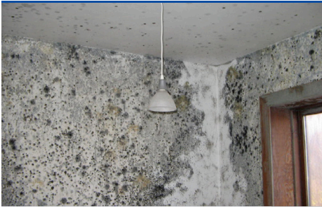
Schimmelpilzwachstum in Wohnzimmer nach Wasserschaden. (Foto: Protox/Kundenfoto)
