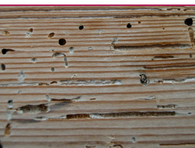
i 11 Gemeiner Nagekäfer – Bodendiele mit freigelegten Larvengängen nach Abhobeln. (Foto: Prottox)
