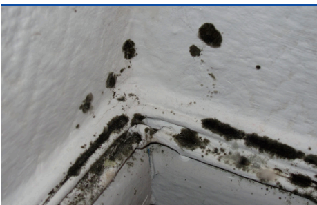
Schwärzepilz auf Fußleiste – als Folge von unzureichendem Lüften. (Foto: Protox)
