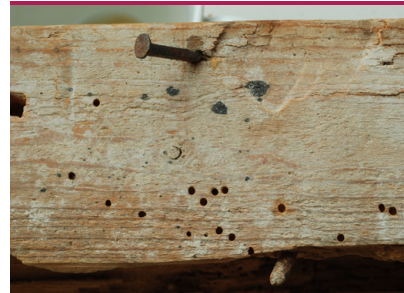
Troitzkopf - Schlupflöcher in Holzlatte. (Foto: Goritas)
