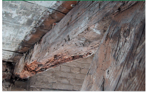
Allgemeine Fäulnis in freigelegtem Dachbalken. (Foto: Protox)
