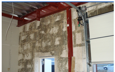
Schimmelpilzwachstum auf neu errichteter Wand in Industriehalle als Folge von Baufeuchte. (Foto: Protox)
