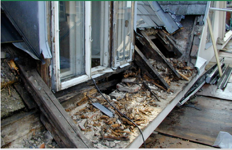
Allgemeine Fäulnis- zerfallener Dachfuß. (Foto: Tryk Forsikring)
