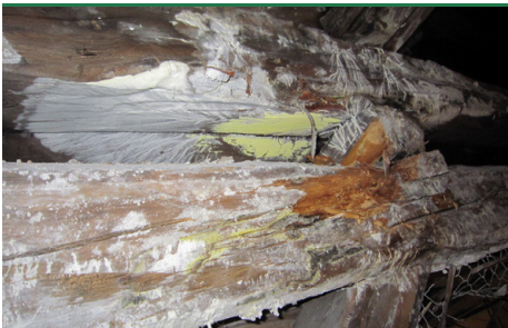
Weißer Porenschwamm – Befall in Dachkonstruktion. Kalkartige Fruchtkörper, junges, weißes Myzel und biegsame Stränge. (Foto: Bøgh & Helstrup)
