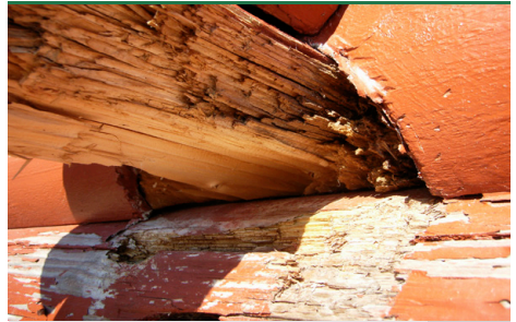
Blättling - Zersetzung in einem Blockhaus. (Foto: Protox)
