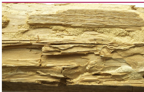
in 13 Hausbock - freigelegte Larvengänge. (Foto: Protox/Goritas Archiv)
