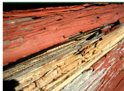
Korkhat - nedbrydning med typisk bladning af årringene, bjælkehus. (Foto: Protox)
