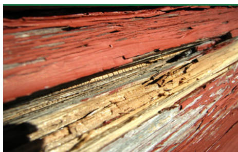
Korkhat - bladet nedbrydning i bjælkehus. (Foto: Protox)
