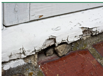
Gråmuld (Overfladeråd) - drypnæse på gammelt vindue.
