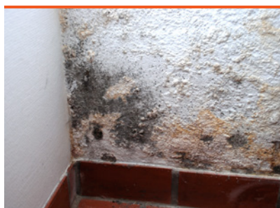
Skimmelangreb i kælderrum
