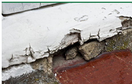
Overfladeråd (gråmuld) - drypnæse på gammelt vindue. (Foto: Protox)
