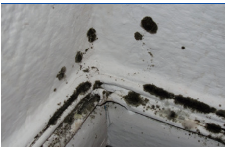
Sortskimmel på fodliste - mangelfuld udluffning. (Foto: Prottox)
