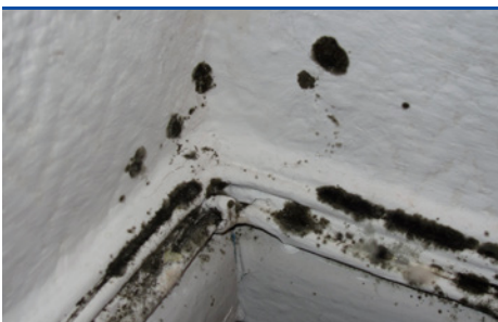
Schwärzepilz auf Fußleiste - als Folge von unzureichendem Lüften. (Foto: Prottox)
