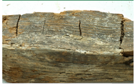
Echter Hausschwamm - alter Befall. Schwache Myzelreste und deutlich querverlaufende Risse. (Foto: Protox/Goritas Archiv)
