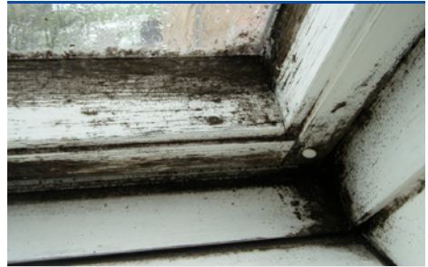
skn 4 Schwärzepilz auf Dachfenster - als Folge unzureichender Lüftung. (Foto: Prottox)
