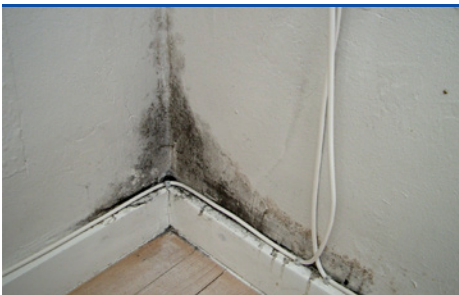
skn 5 Schwärzepilz in Wohnzimmer - durch Wärmebrücke verursacht. (Foto: Prottox)
