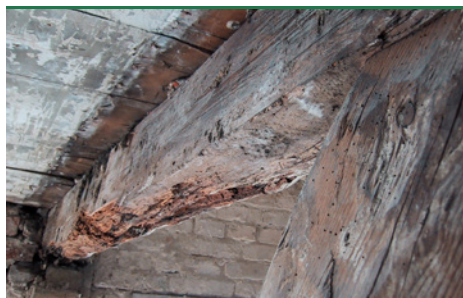
Allgemeine Fäulnis in freigelegtem Dachbalken. (Foto: Prottox)
