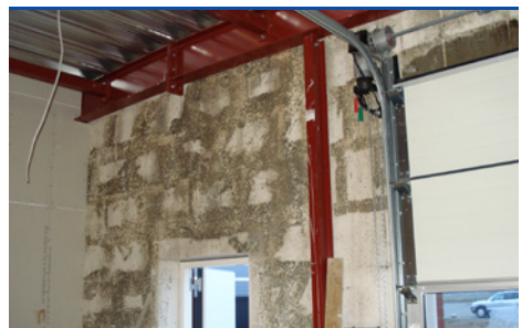
Schimmelwachstum auf neu errichteter Wand in Industriehalle als Folge von Baufeuchte. (Foto: Prottox)
