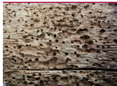
Gescheckter Nagekäfer - Schlupflöcher in altem Balken. (Foto: Protox)
