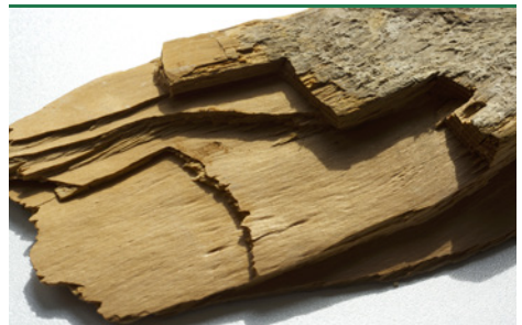
svn 42 Brauner Kellerschwamm - Braunfäule, Zersetzung mit Abblättern. Bewertung als Pilzschaden. (Foto: Protox/Goritas Archiv)
