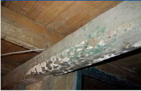
skn 1 Schimmelwachstum ( Trichoderma sp.) auf Balken im Keller (durch Wasserschaden verursacht). (Foto: Prottox)
