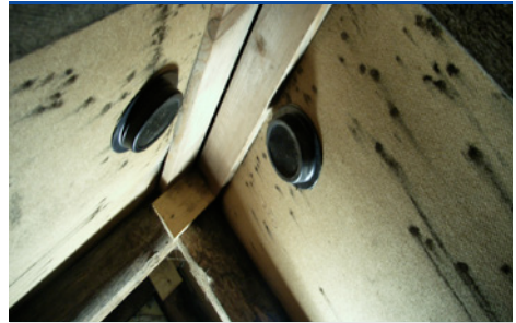
Schwärzepilz auf Unterdachkonstruktion auf Grund unzureichender Lüftung des Dachbodens (Lüftung nachträglich angebracht). (Foto: Prottox)
