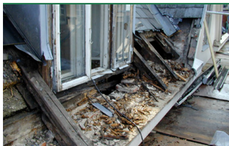
Allgemeine Fäulnis- zerfallener Dachfuß. (Foto: Tryk Forsikring)
