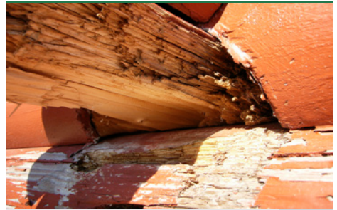
Blättling - Zersetzung in einem Blockhaus. (Foto: Protox)
