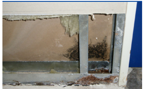
Schimmelwachstum ( Stachybotris chartarum ) auf leichter Gipswand nach Überschwemmung. (Foto: Prottox)
