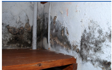
skn 6 Schwärzepilz auf feuchtem Kellerfundament. (Foto: Prottox)
