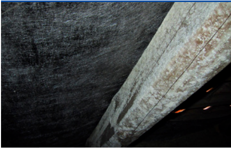
skn 3 Schimmelwachstum ( Penicillium sp.) auf Dachsparren als Folge unzureichender Lüftung. (Foto: Prottox)
