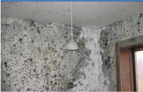
Schimmelwachstum in Wohnzimmer nach Wasserschaden. (Foto: Prottox/Kundenfoto)
