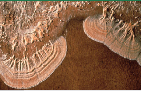
svn 37 Blättling - Oberflächenmyzel in Flachdach aus Sperrholz. (Foto: Protox/Gorits)
