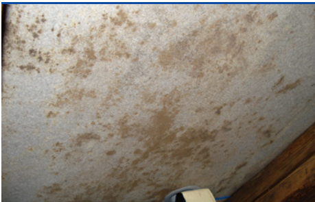
Schimmelwachstum auf diffusionsdichtem Unterdach (gefiltzte Oberfläche). (Foto: Prottox)
