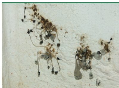
Haustintling - eingetrocknete Fruchtkörper auf verputzter Wand. (Foto: Goritas)
