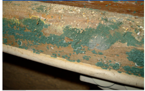
skn 2 Schimmelwachstum ( Trichoderma sp.) auf Schalbrett in Kriechkeller mit Wasserschaden. (Foto: Prottox)
